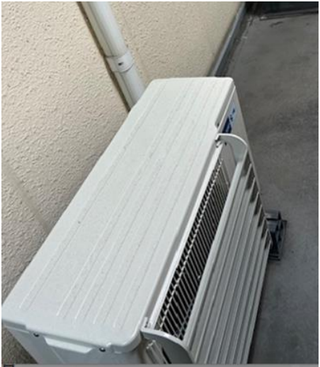
写真4 事務所A室外機
