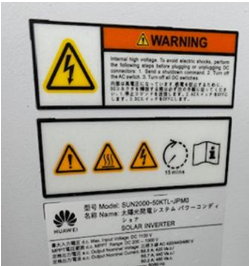
写真5 パソコン定格銘板
