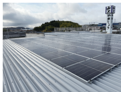
本社に設置された太陽光パネル。
