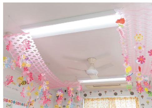
支援を受けて設置した LED 照明
