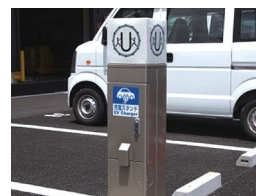
EV充電スタンド
