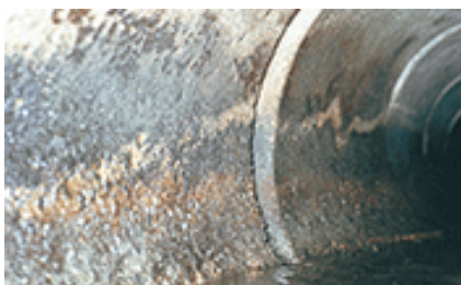
▲改修の必要がある老朽化した下水管。
